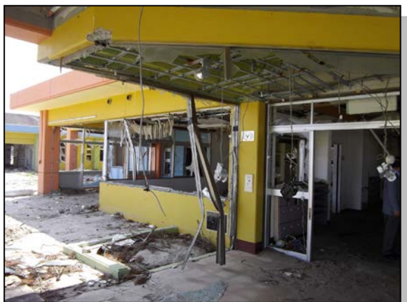
津波により全壊した養護老人ホーム（宮城県）
