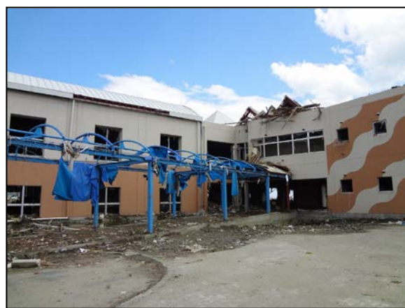
津波により全壊した陸前高田市社協（岩手県）
